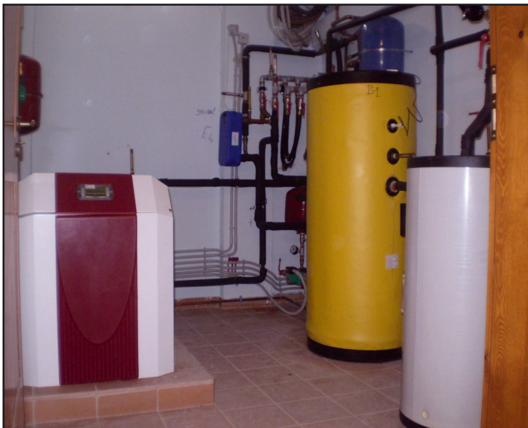
Εικόνα 5: Το μηχανοστάσιο με τη Γεωθερμική Αντλία θερμότητας Dimplex και τις δεξαμενές αποθήκευσης ηλιακής ενέργειας με σκοπό τη βοηθητική στήριξη της παραγωγής ζεστών νερών χρήσης και της κάλυψης της θέρμανσης χώρων με σώματα καλοριφέρ, στη γεωθερμική κατοικία Μισιακού στην Παιανία Αττικής (BONAIR, 2010).
