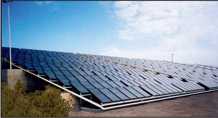
Εικόνα 3: ΨΒ-Ηλιακό σύστημα ηλιακής ψύξης ετοιμών προϊόντων στο εργοστάσιο καλλυντικών Σαράντης ΑΕΒΕΕ στα Οινόφυτα Βοιωτίας ολικής συλλεκτικής επιφάνειας 2.800 m 2 και ψυκτικής ισχύος 700 kW [ΣΟΛΕ Α.Ε., 2004, www.sole.gr ].
